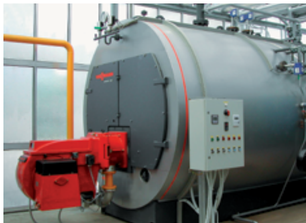
Chaudière vapeur haute pression Vitomax 200-HS dans une exploitation horticole
