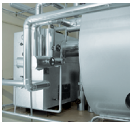
Chaudière à vapeur Vitomax 200-HS avec économiseur placé en aval
