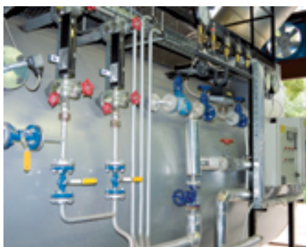
Robinetteries de chaudière
