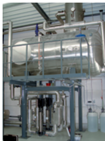
Bâche alimentaire avec dégazage thermique
