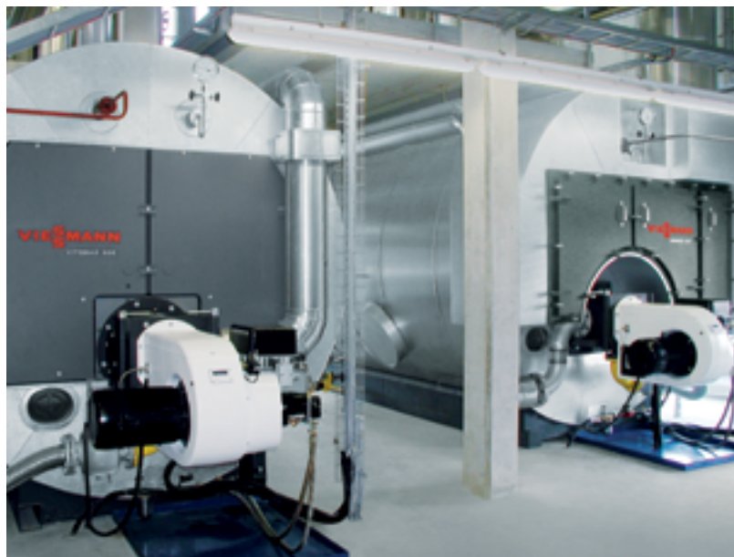
Chaudière à vapeur avec récupération de chaleur associée à une chaudière à vapeur conventionnelle
