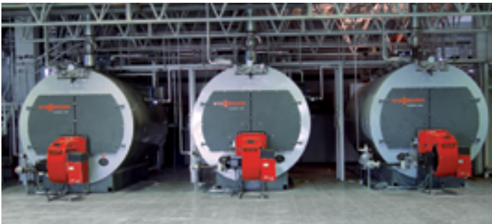
Chaudière à vapeur chez Sanovel à Istanbul, Turquie
