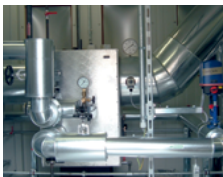
Economiseur situé en aval
