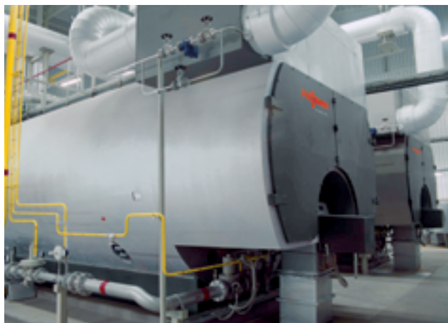
Chaudière à vapeur avec surchauffeur chez Klaipėdos Kartonai, Lituanie
