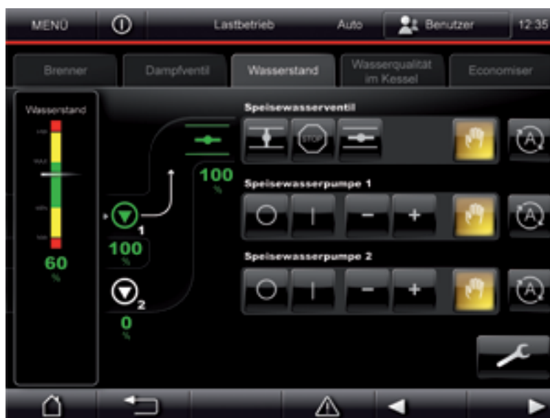
Représentation du niveau de réglage de la vanne de régulation de l'eau d'alimentation
