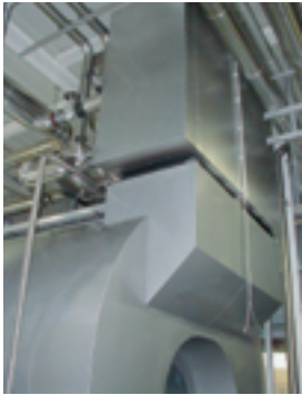
Economiseur installé sur une Vitomax 200-HS
