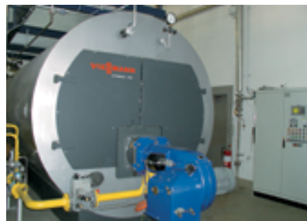
Chaudière à vapeur chez AZM Asur, Belgique
