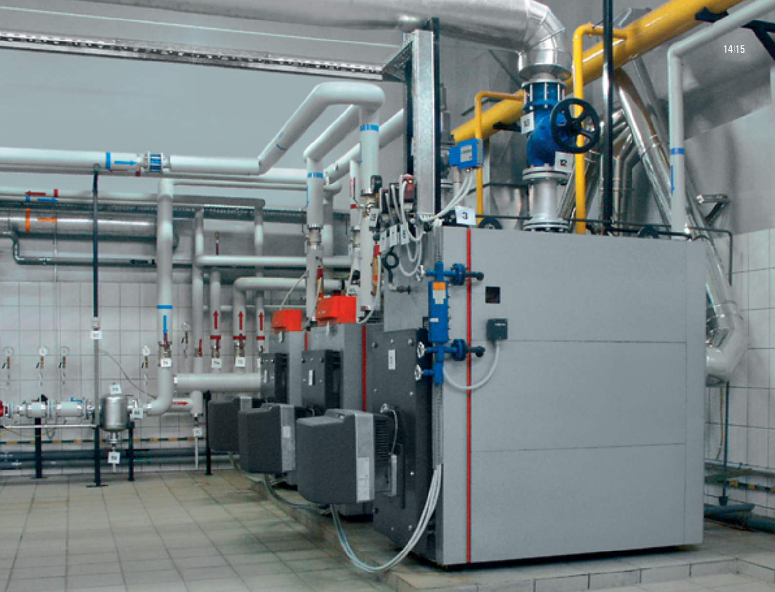
Installation avec une chaudière vapeur basse pression Vitoplex 100-LS ainsi que deux chaudières à eau chaude Vitoplex
