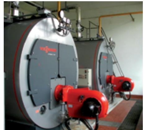
Chaudière à vapeur pour industrie textile Rivolta Carmignani à Milan, Italie
