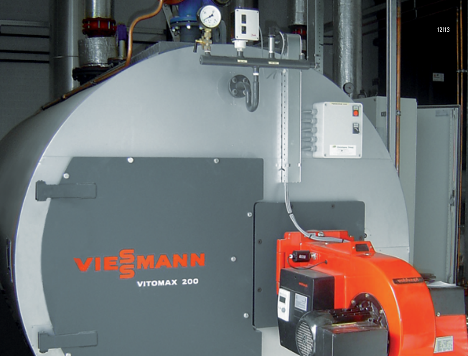
Chaudière vapeur basse pression Vitomax 200-LS, installation Deckers Pilzen, Pays-Bas
